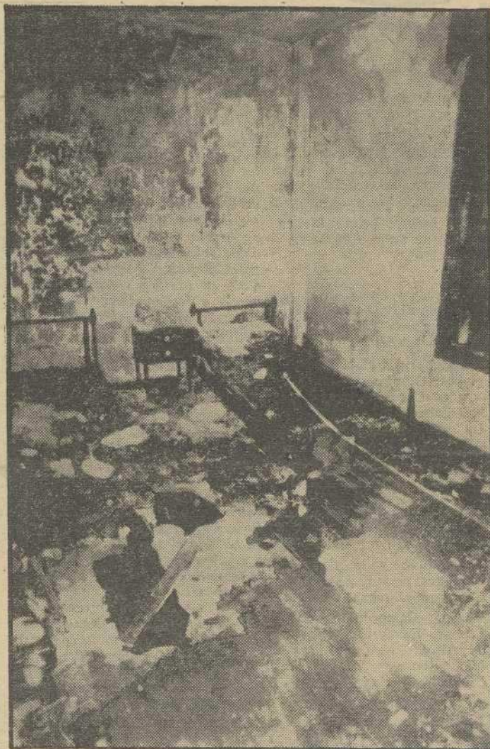
Unas sesenta familias tuvieron que ser desalojadas de varios edificios colindantes con las oficinas de "Iberduero" de Guecho (Vizcaya), a consecuencia de la onda explosiva de un artefacto colocado en dicho lugar. La fotografía recoge un lugar afectado por la explosión. — (Foto EFE)
