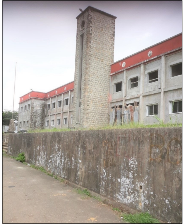
Obra de la reforma del edificio del Colegio Enrique Nvó, en Bata, paralizada desde hace más de cinco años
